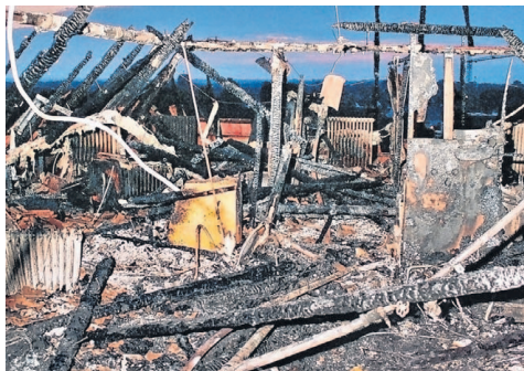
Blick auf vier völlig zerstörte Zimmer der Ordensschwwestern im fünften Obergeschoss. Hier hatten die Bewohnerinnen alles verloren. Archivfotos: Konjer
