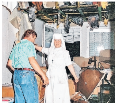
Schwester Bernadette inspiziert mit Handwerker Heinz Oestermann ein zerstörtes Zimmer in der Klausur.
