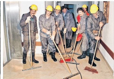
Fleißige Ehrenamtliche des Technischen Hilfswerks halfen beim Aufwischen von Löschwasser und beim Reinigen der Station B1 im ersten Obergeschoss.
